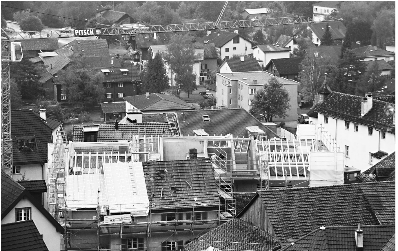
«Grossbaustelle» Haldenstein: Bautätigkeit wie noch nie in unserem Dorf. Im Bild das neue «Dorfzentrum» der Bürgergemeinde.
