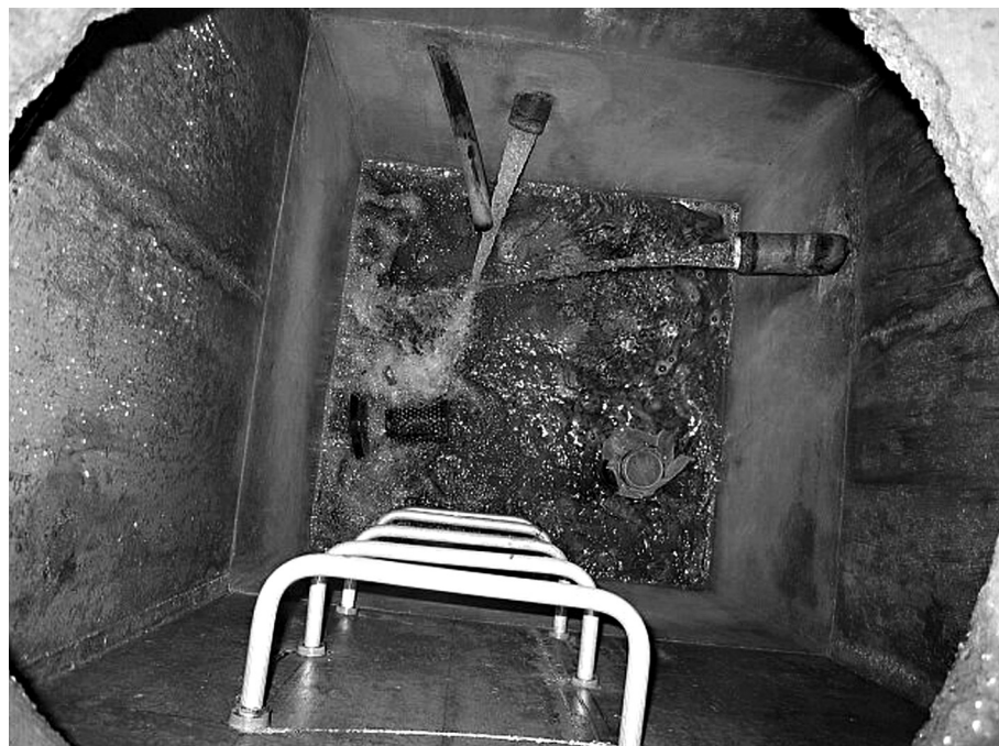
Ein Blick in einen Sammelschacht.
