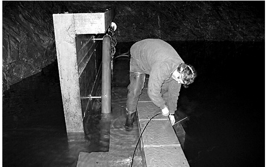
Werkmeister Martin «Tini» Schwarz bei der Kontrolle der Pumpen in der Carbura.
