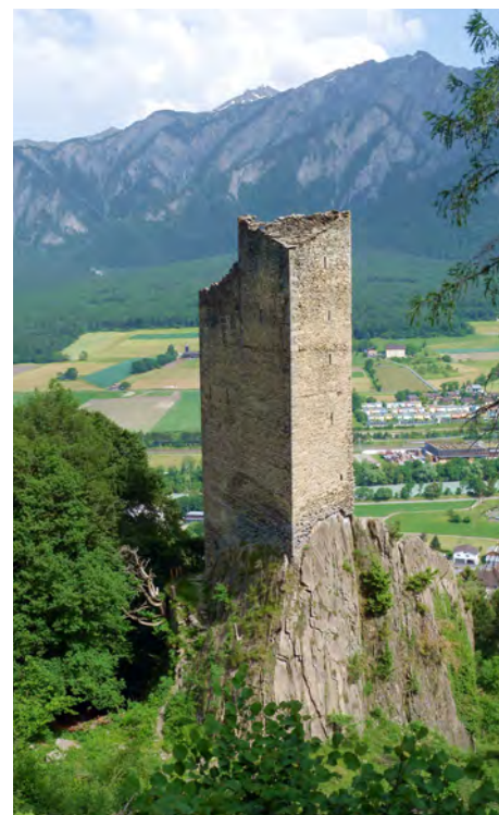
Noch ist der dreieckige Turm bis auf das Pultdach erhalten, doch die Witterung setzt den ungeschützten Mauerkronen arg zu... (Foto Augustin Carigiet)
