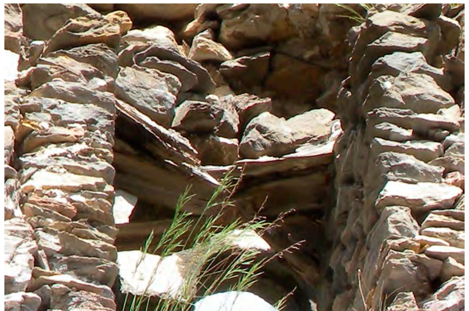
Abb. 15: Fenster mit eingebrochenem Sturzbrett
