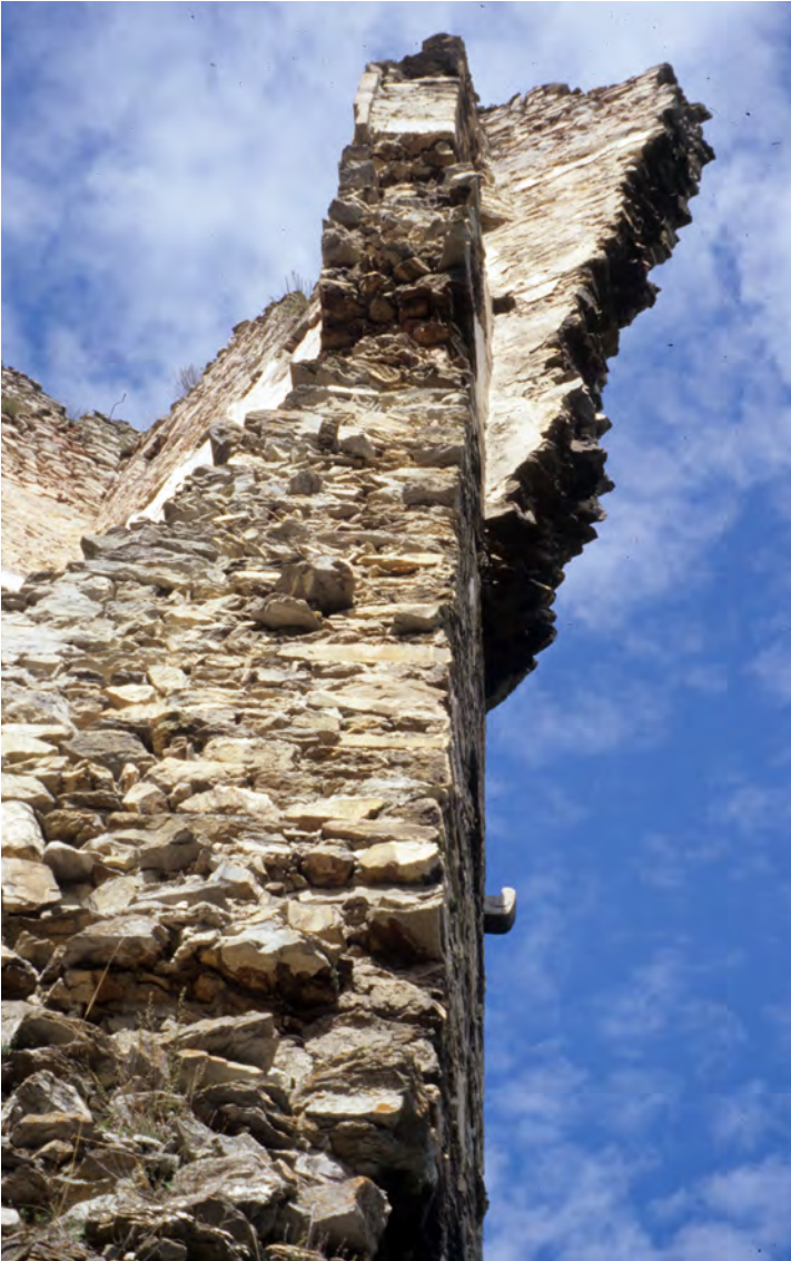
Abb. 13: Der Überhang an der östlichen Abrissstelle, Ansicht von Süden
