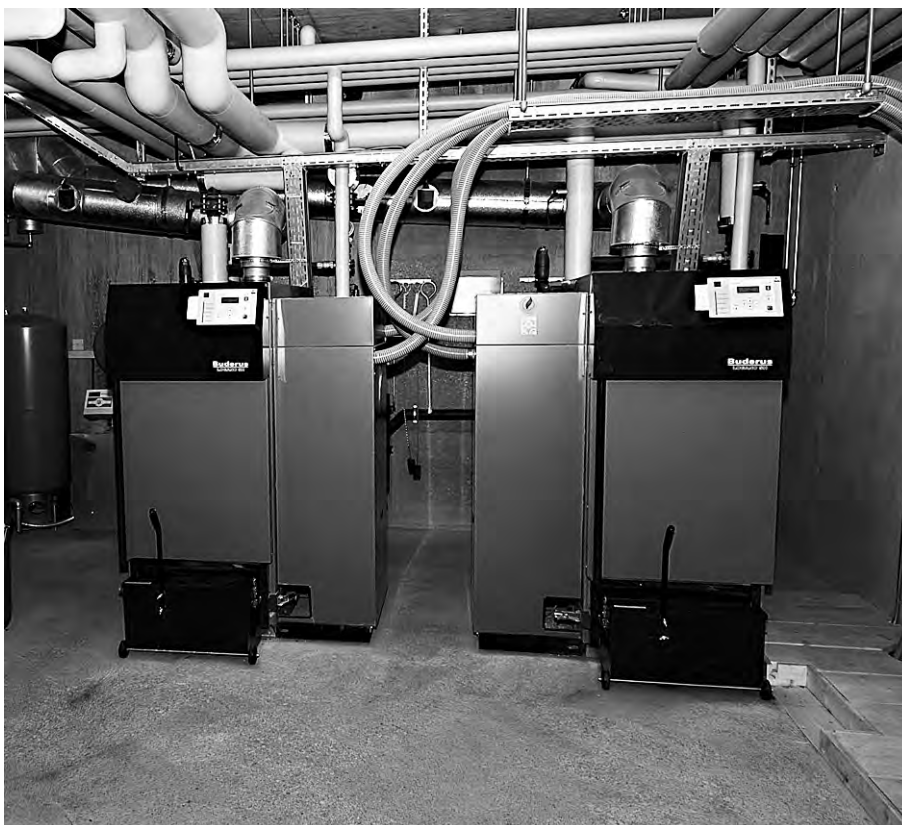
Starke Leistung: die Heizzentrale Dorfzentrum Haldenstein (Pelletheizung).
