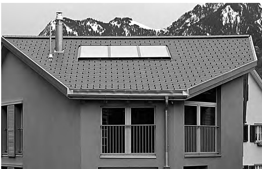
Solaranlage für die Brauchwasseraufbereitung auf dem Haus Rüdlinger.
